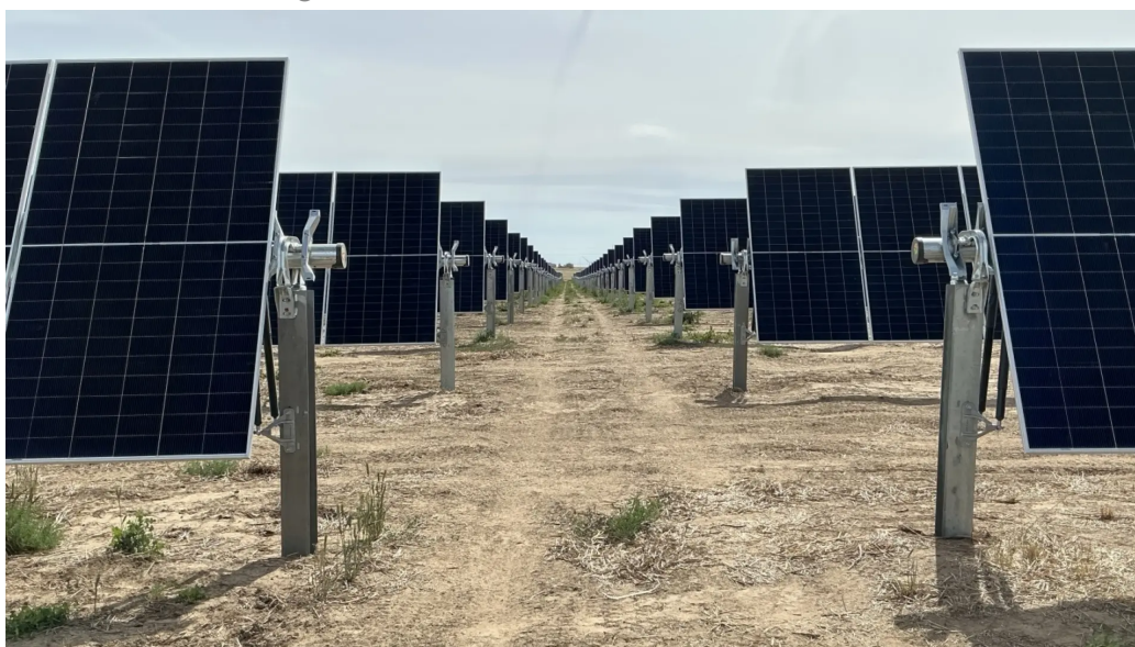
Planta solar de Iberdrola
