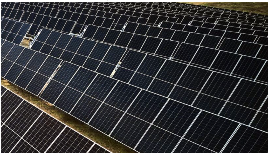
Parque solar de TotalEnergies.
