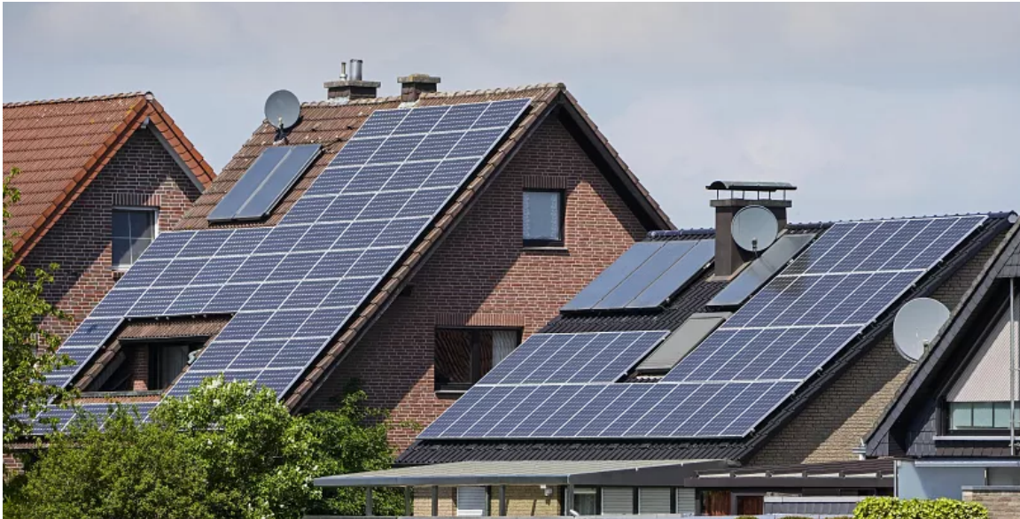
Canarias duplica la potencia de autoconsumo fotovoltaico y supera los 300 MW instalados
