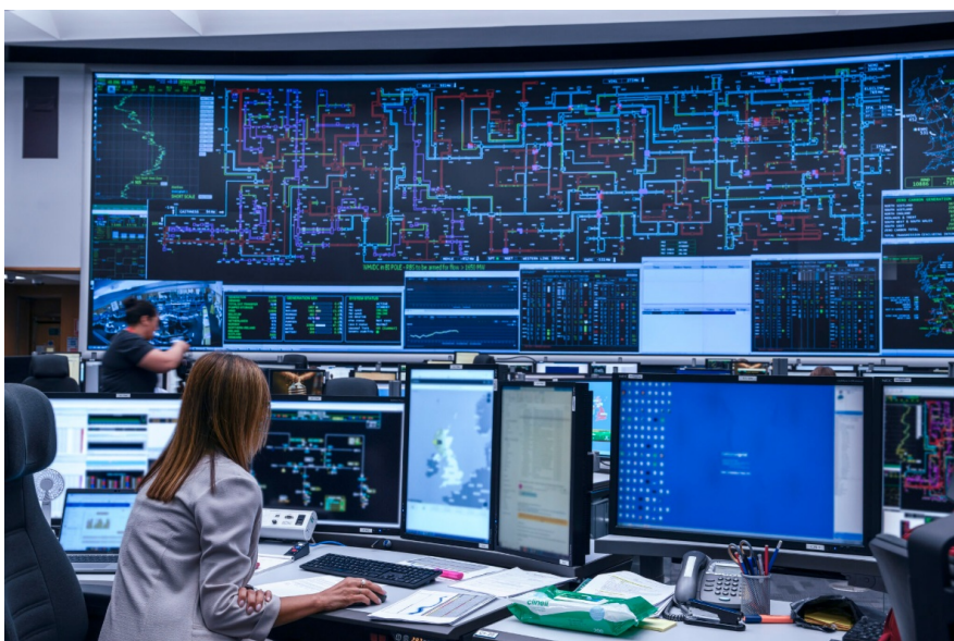
Sala de control de NESO.
