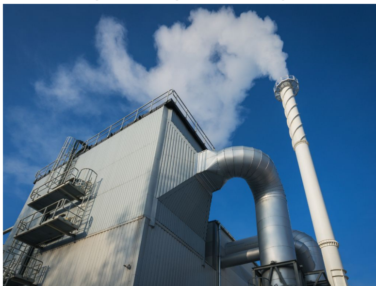
planta de biomasa
