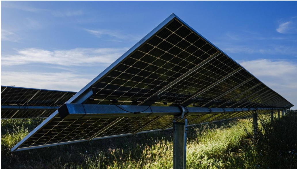
Paneles solares fotovoltaicos en una instalación
