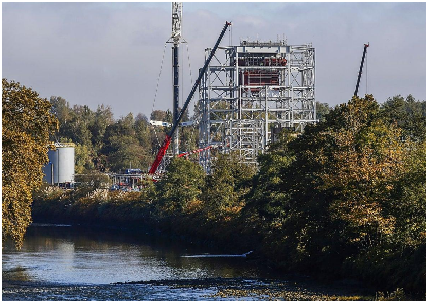
Instalación de biomasa para energía renovable
