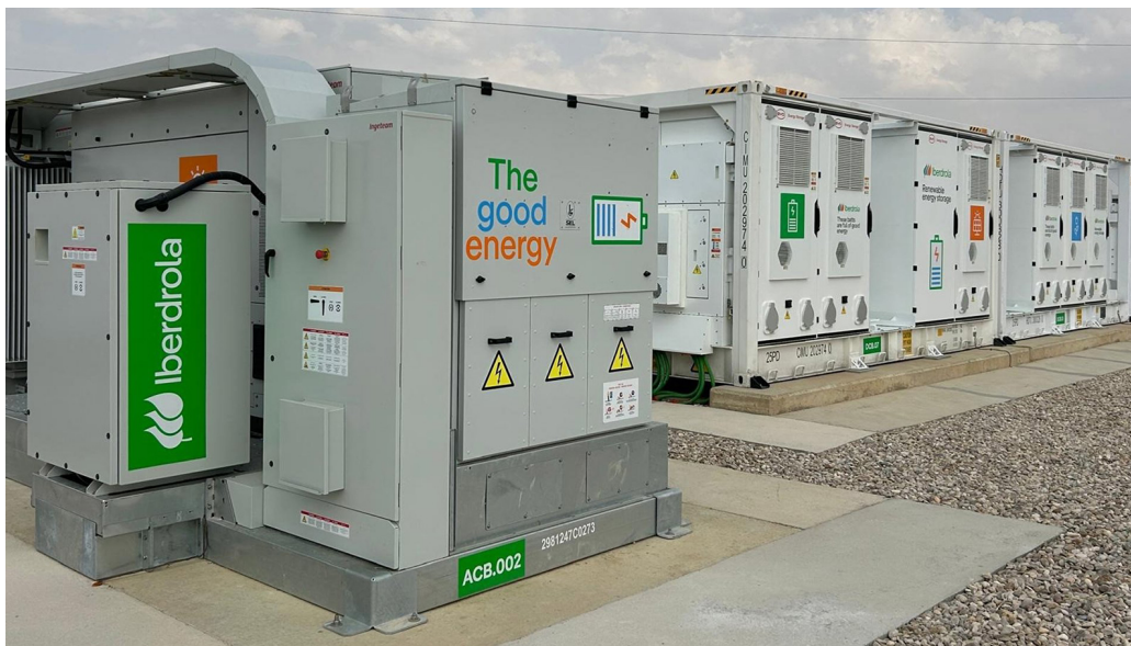
Proyecto de baterías de Iberdrola.
