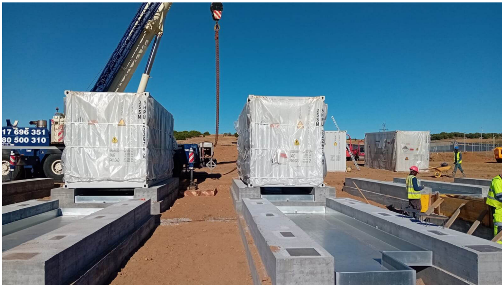
Solaria compra 516 MWh de baterías para instalar en ocho de sus proyectos en España.
