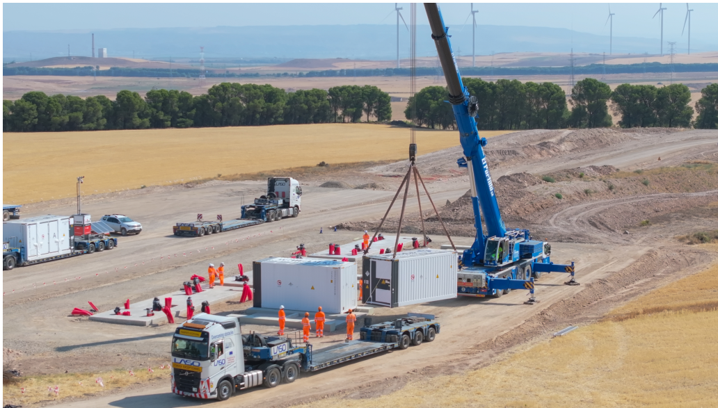
Statkraft instala sus primeras baterías en España para hibridar su parque eólico repotenciado Montes de Cierzo en Navarra
