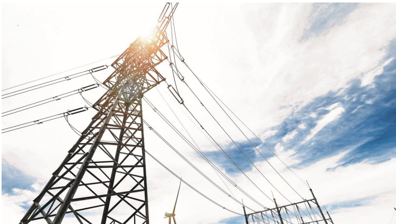
Red eléctrica de Neoenergía (Iberdrola) en Brasil.
