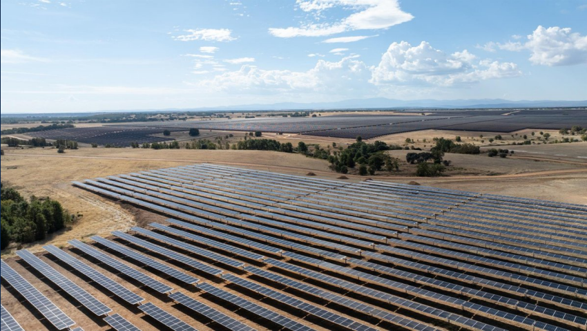
Recurrent Energy pone en operación comercial una planta fotovoltaica de 200 MW en Castilla y León
