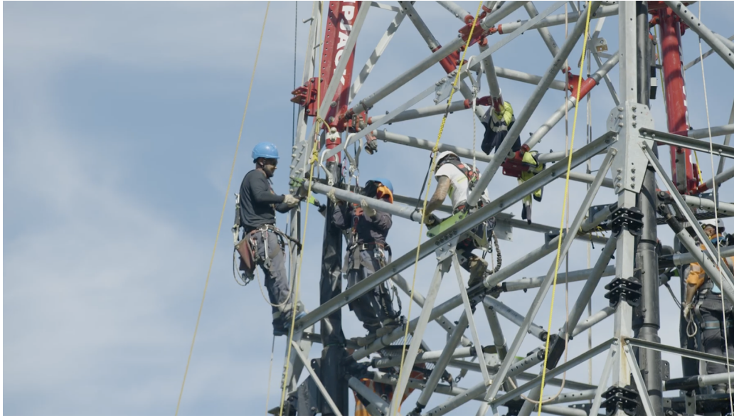
La interconexión eléctrica con Francia entre Hernani y Argia se repotencia con tecnología de vanguardia.
