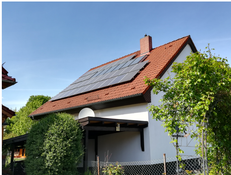
Instalación solar en tejado en Alemania
