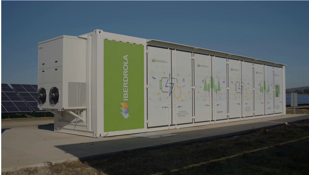
Iberdrola pone en operación las baterías más grandes de España en Alarcón
