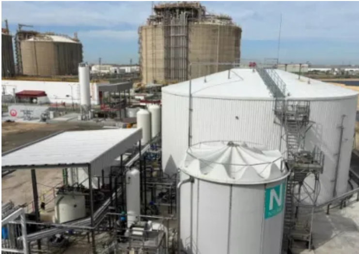
Veolia logra su primera inyección de biometano a partir de residuos industriales en la red de gas natural de Andalucía
