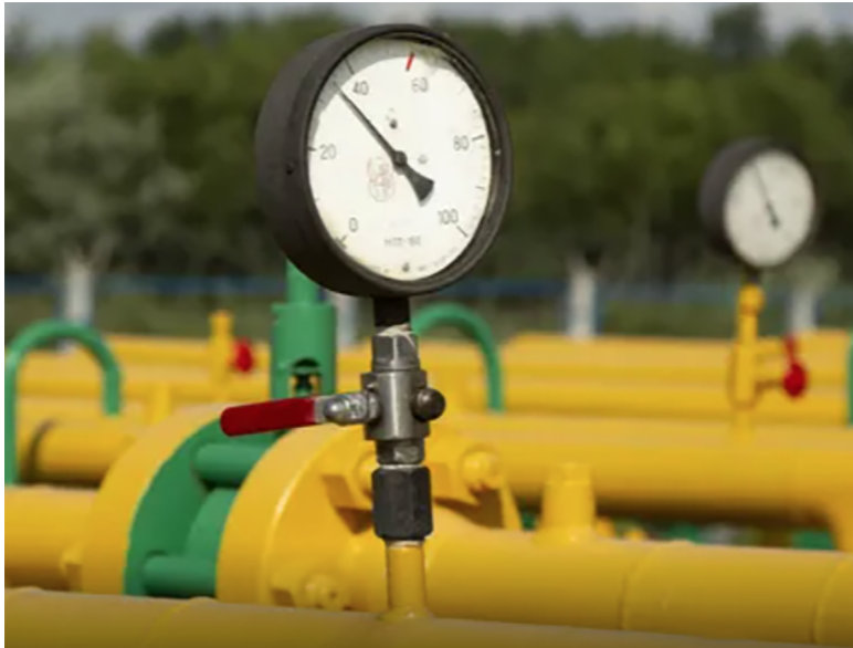
Instalaciones de gas de Naftogaz en Ucrania.
