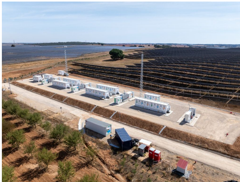
Entran en operación en Cuenca las dos baterías híbridadas de mayor capacidad de España.
