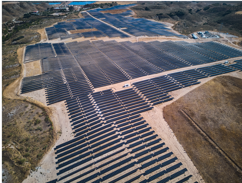
La planta fotovoltaica de TotalEnergies en Seseña, Toledo.
