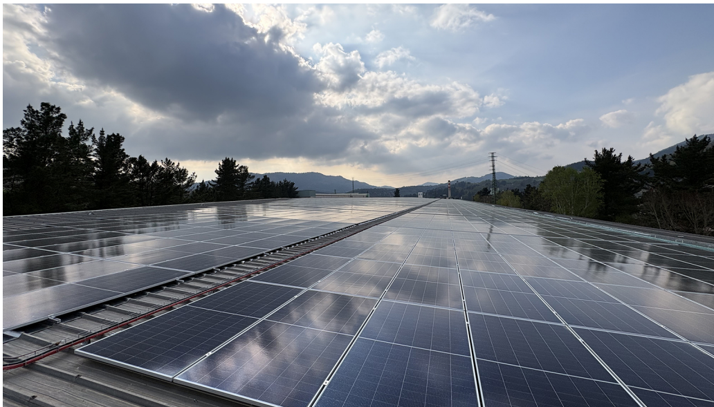
Vidrala invierte en una planta fotovoltaica de autoconsumo de 7MW en Llodio.
