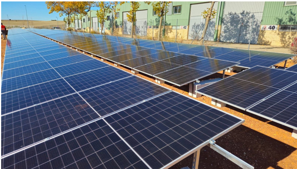
Instalación en Conway en Quer (Guadalajara).
