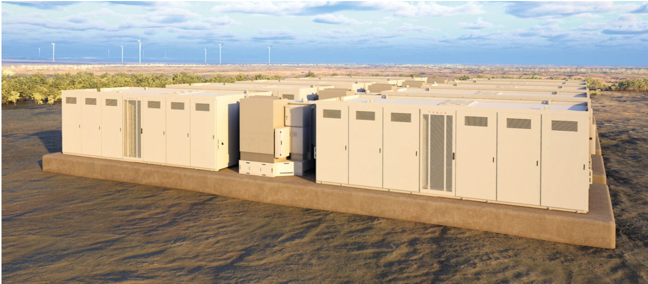
Neoen duplicará la capacidad de su gran batería en el mayor polo de energías renovables de Australia
