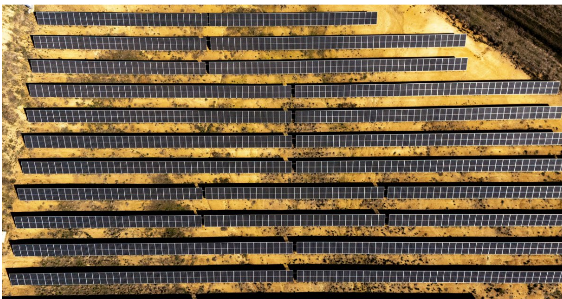
Planta fotovoltaica de Raiola Future en Orense
