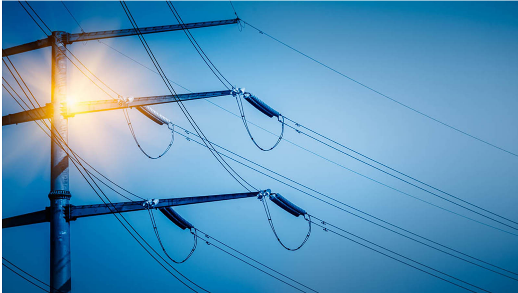
Infraestructuras eléctricas en la España rural.
