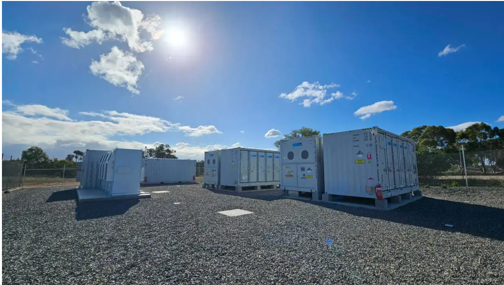
La pequeña gran batería que busca reforzar la red eléctrica renovable de Australia
