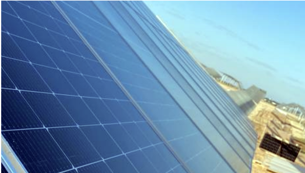
Instalaciones de Alter Enersun.
