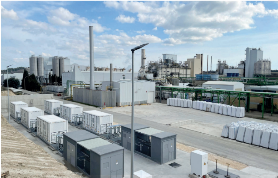
UNEF celebrará la IV Cumbre Internacional de Almacenamiento e Hidrógeno el próximo 4 y 5 de marzo de 2026 en Madrid
