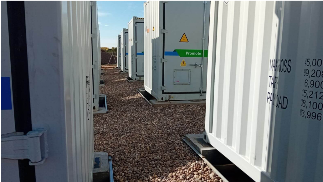
Solaria obtiene autorización ambiental para 1 GWh adicional de almacenamiento y roza los 3GWh aprobados en España.
