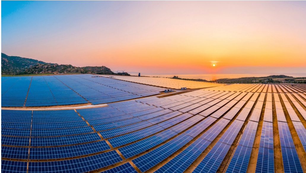
Planta fotovoltaica de Atome.
