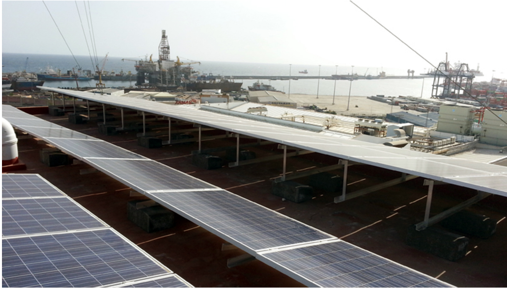
Instalación de autoconsumo de Clean Canarian Energy SL.
