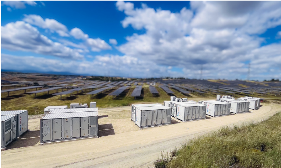
Trina Storage pone en marcha su primer proyecto de almacenamiento de energía en baterías en Portugal junto con Prosolia Energy.
