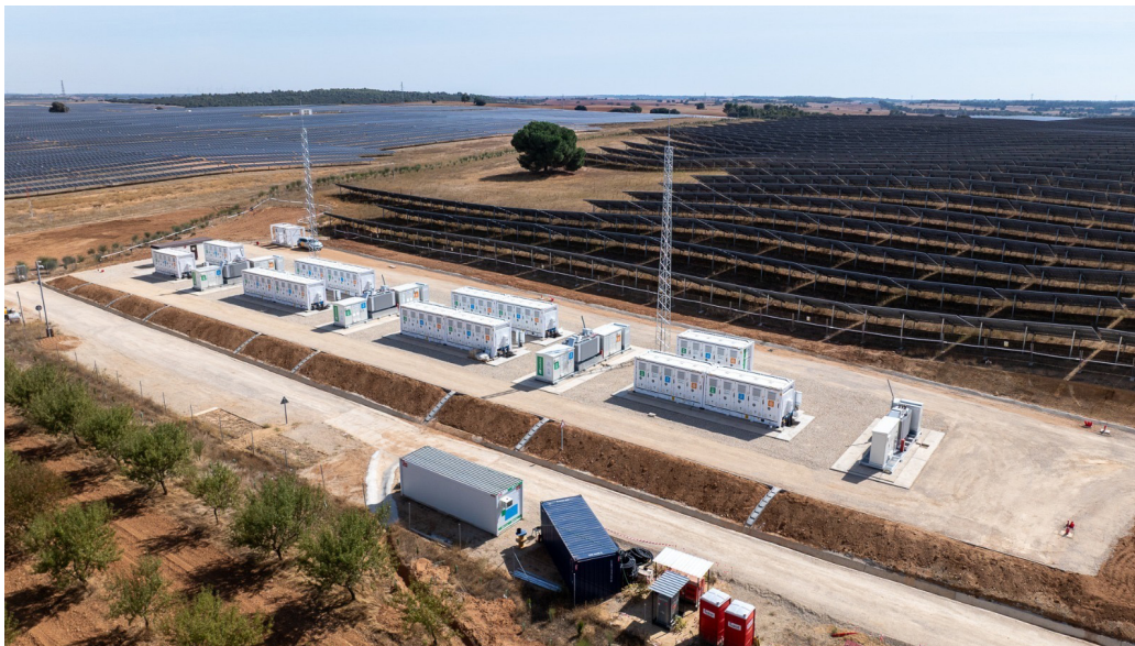
Iberdrola pone en operación las baterías más grandes de España.
