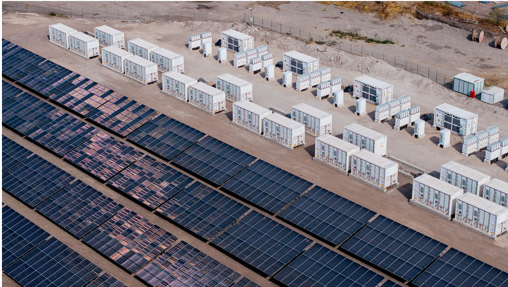
La UE eleva un 45% la instalación de baterías de almacenamiento en 2025, con 27,1 GWh más.
