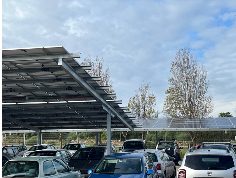
El aparcamiento de Poniente en Benidorm tendrá una instalación solar fotovoltaica de autoconsumo colectivo
