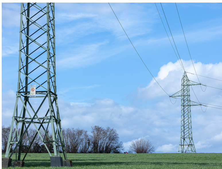
Torres eléctricas para el transporte de electricidad a largas distancias.
