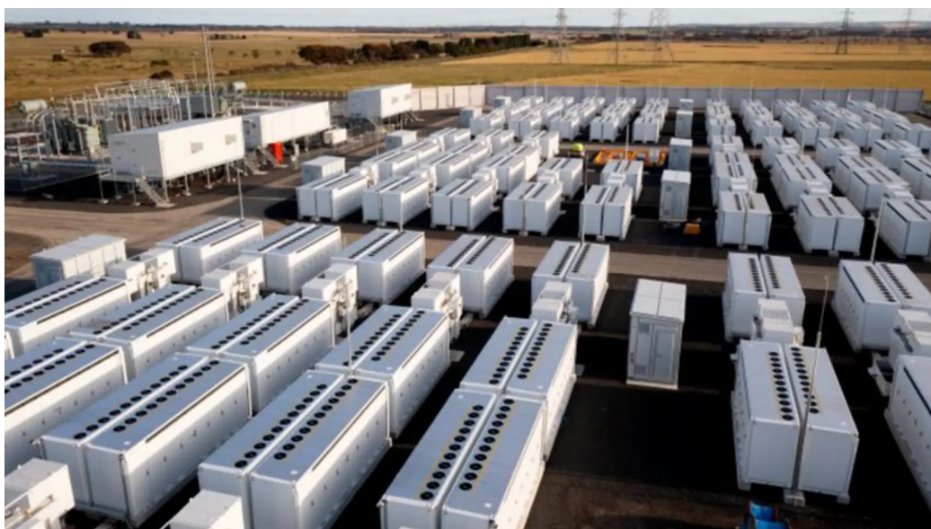
La capacidad mundial de almacenamiento energético en baterías se multiplicará por seis hasta 2030
