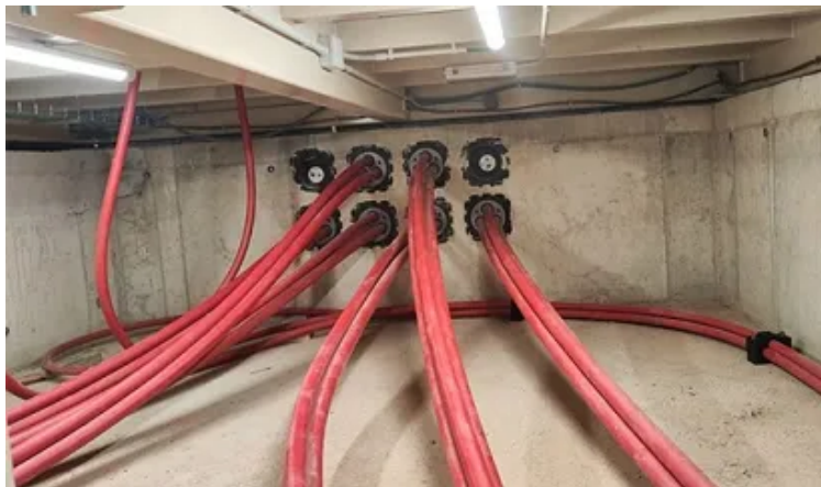
Roxtec y Sarpel Ingeniería colaboran en la protección de subestaciones eólicas y fotovoltaicas
