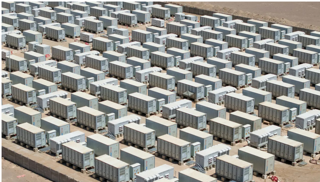
Proyecto de baterías de Copenhagen Infrastructure Partners.
