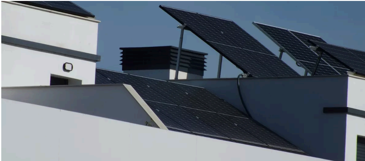
Placas der una instalación fotovoltaica en un edificio de CórdobaLa Voz
