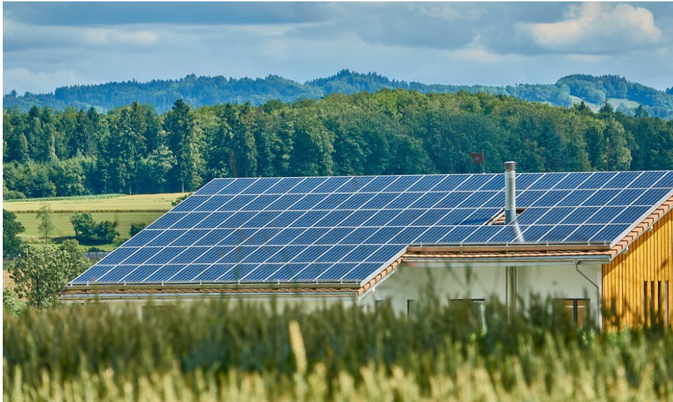
Parque solar fotovoltaico
