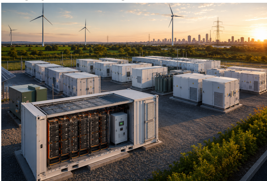
El almacenamiento energético entra en la primera división de la industria eléctrica
