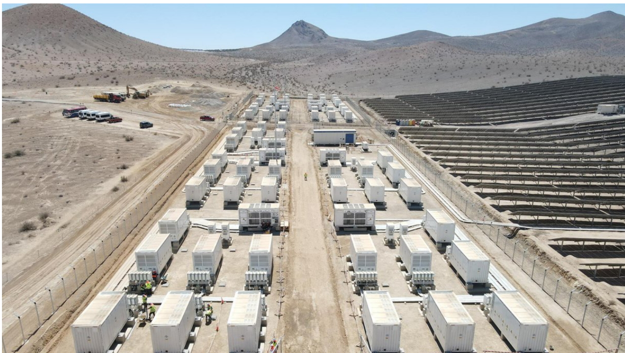
Engie energiza una batería hibridada con un parque fotovoltaico en el desierto de Atacama (Chile).
