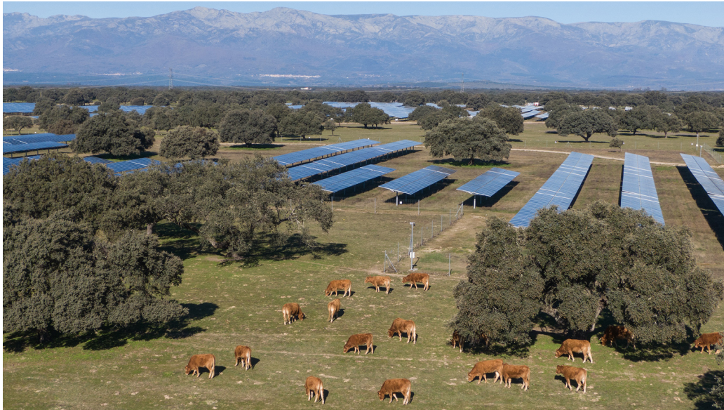
La planta solar fotovoltaica de Talayuela II, en la provincia de Cáceres.
