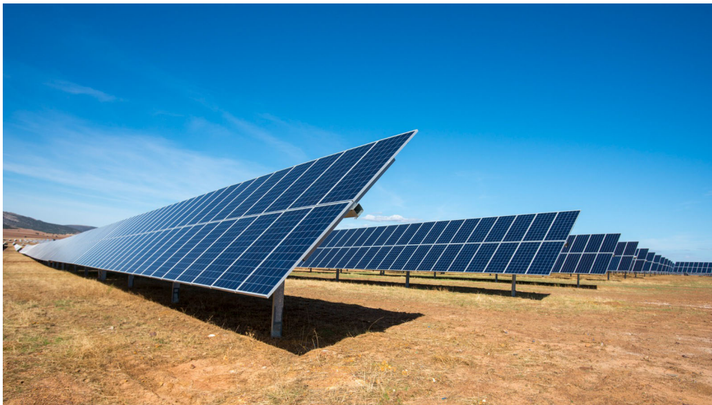
Las plantas fotovoltaicas Picón I, II y III de Naturgy en Ciudad Real.
