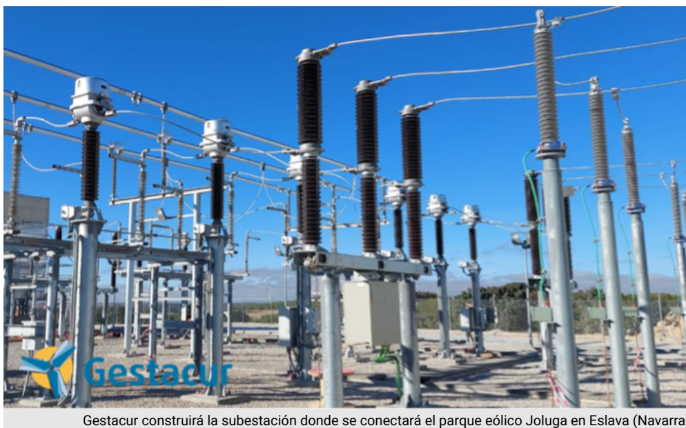
Gestacur construirá la subestación donde se conectará el parque eólico Joluga en Eslava (Navarra)
