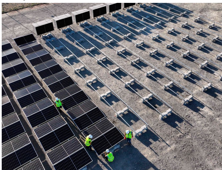
La fotovoltaica avanza hacia nueva velocidad de ejecución de la mano de la innovación y la ingeniería modular.
