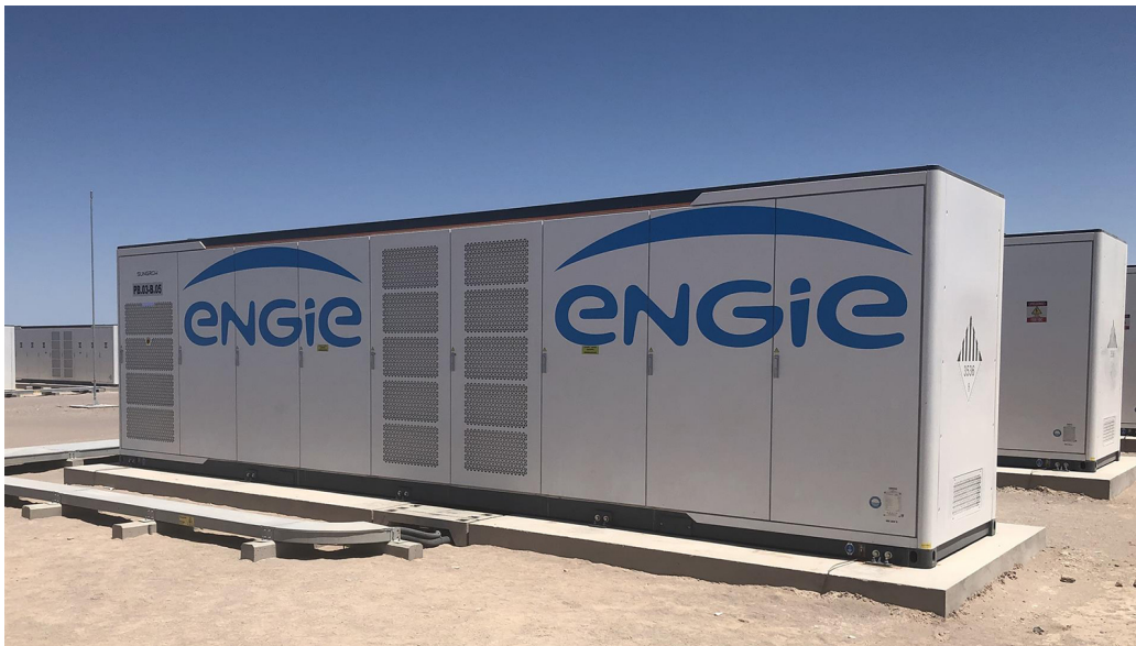
Engie acelera su ambición con la adquisición de dos proyectos de almacenamiento de baterías a Rolwind.
