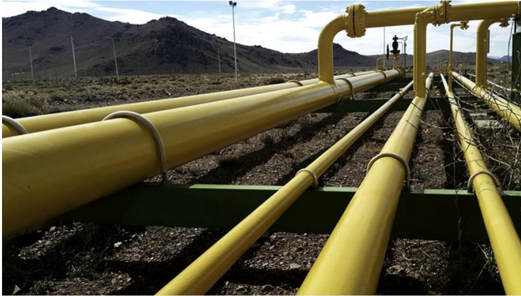
Perú declara en emergencia el suministro de gas natural por la fuga en un gasoducto
