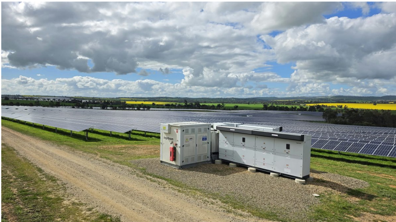
Ingeteam pone en marcha 236 MVA de capacidad fotovoltaica en Australia.
