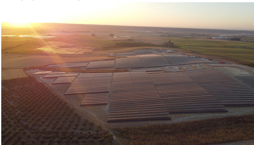
Planta solar fotovoltaica Arco 8 de Solarig en Sevilla.
