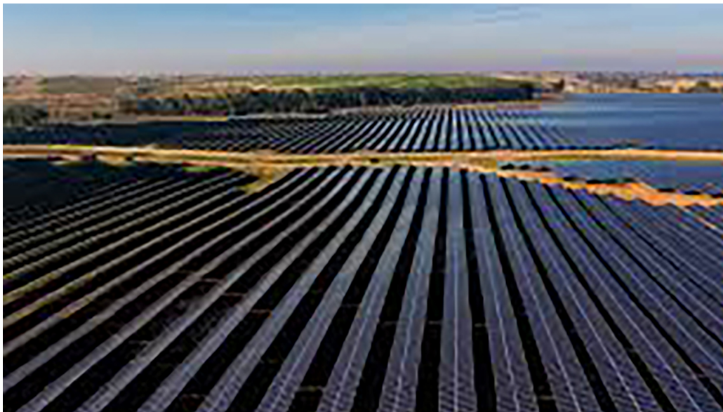
Planta fotovoltaica de Prodiel.
